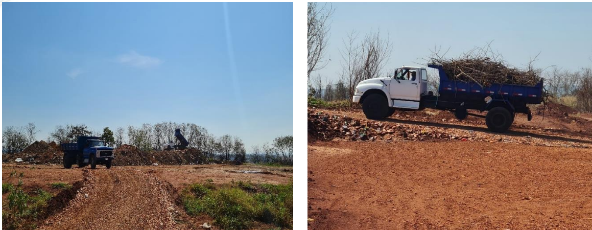
Figura 64 e 65 – Disposição de resíduos sólidos verdes Fonte: Amplar Engenharia
